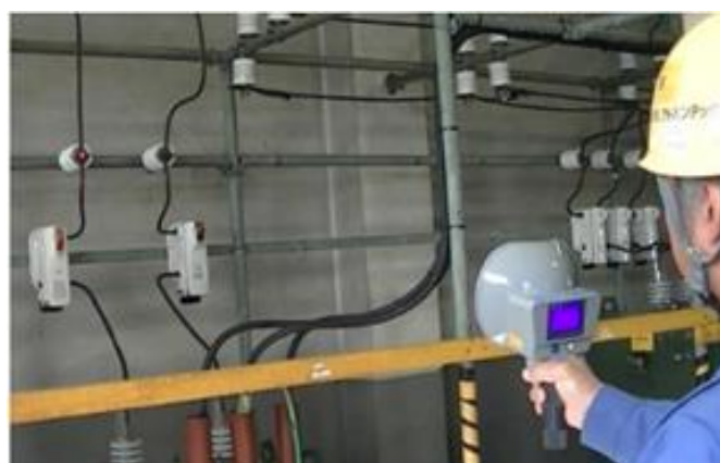
Hình 4 Kiểm tra thiết bị điện trong nhà máy
