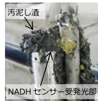
写真 5.1 汚泥付着状況
